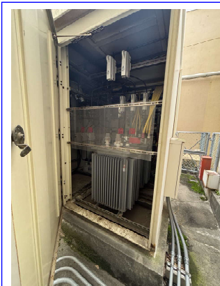
【変圧器】三相50kVA/単相30kVA
