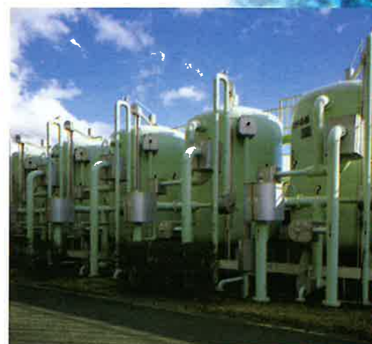
ろ過設備(山田川浄化センター)
