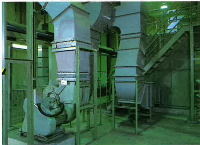
脱臭設備（吸着塔）
