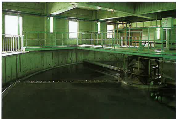
最終沈でん池
