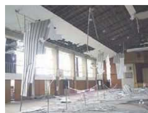
〔①東日本大震災における天井落下〕
