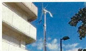
[小型風力発電機(鹿ノ台中学校)]
