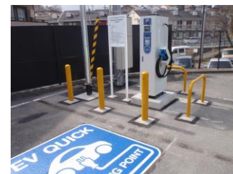
電気自動車用急速充電器
