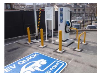
電気自動車用急速充電器
