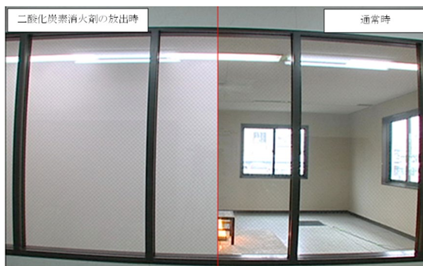
図 二酸化炭素消火剤の放出時と通常時における視界の比較
