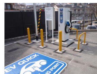
電気自動車用急速充電器
