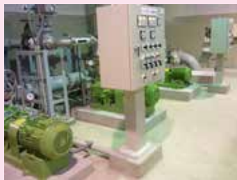
新しくなったひかりが丘配水場の電気設備
