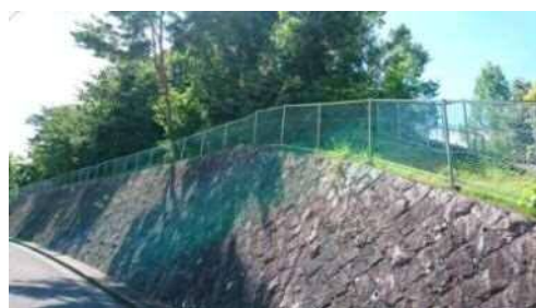
北側からハザードを撮影
