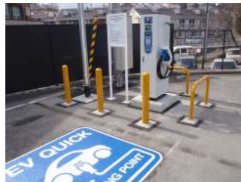
電気自動車用急速充電器
