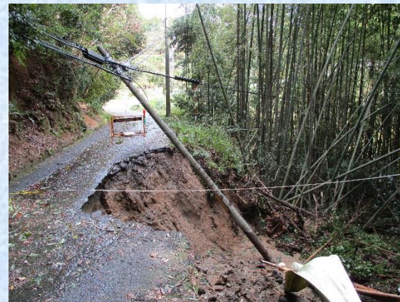
生駒市での台風による被害
