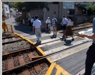
萩の台第5踏切が狭く、危険。踏切内に段差が多い。
