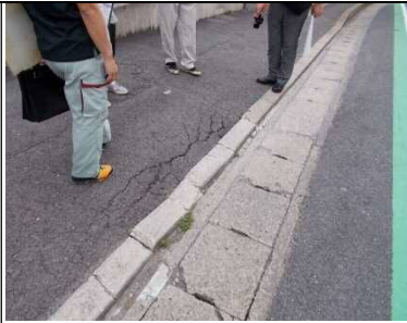
西口に車が乗り上げ、縁石、アスファルトに傷みがある。
