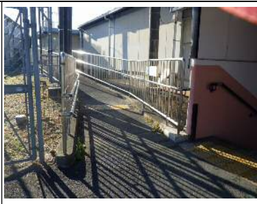
東口外部階段とスロープの距離が近く、転落のおそれがある。
