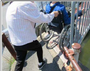
小瀬橋は雨が降るとすべる。滑り止めがほしい。
