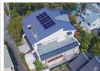
萩の台住宅地自治会館の屋根に設置された太陽光パネル
