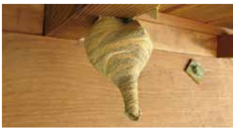
スズメバチの巣(初期段階)
