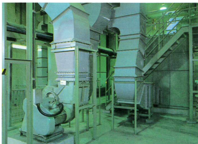
脱臭設備(吸着塔)
