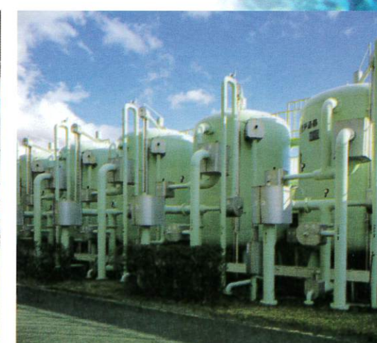
ろ過設備(山田川浄化センター)
