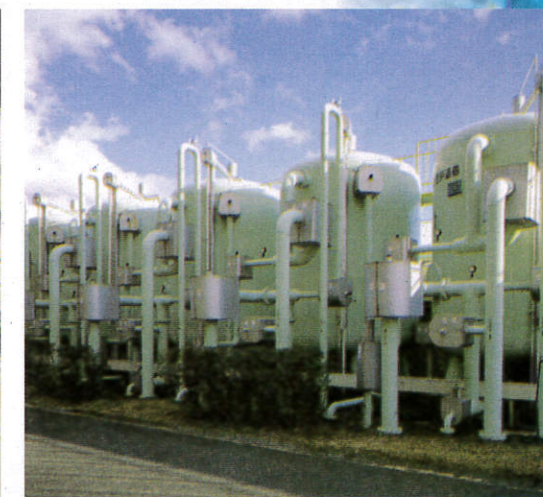
ろ過設備(山田川浄化センター)
