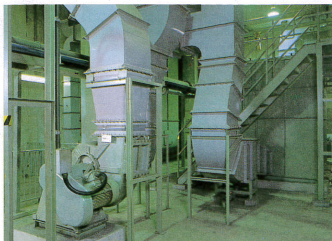
脱臭設備(吸着塔)
