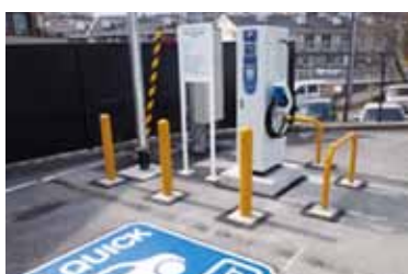
エネルギーステーション
