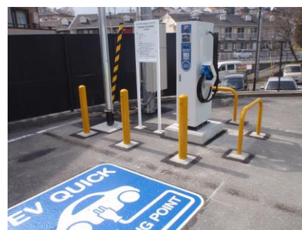
電気自動車用急速充電器
