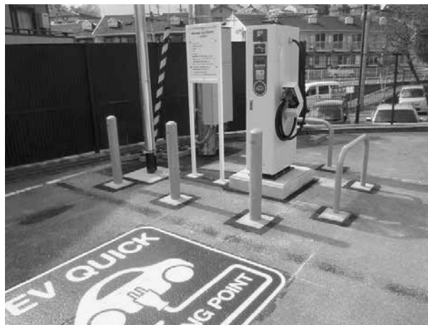
電気自動車用急速充電器
