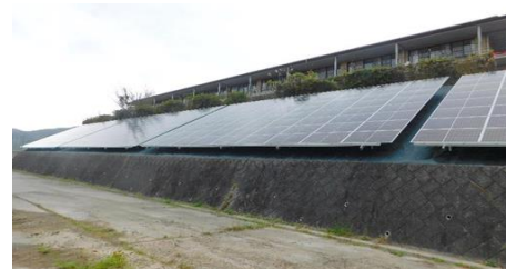
やすらぎの杜優楽に設置した太陽光発電パネル(市民共同太陽光発電所5号機)
