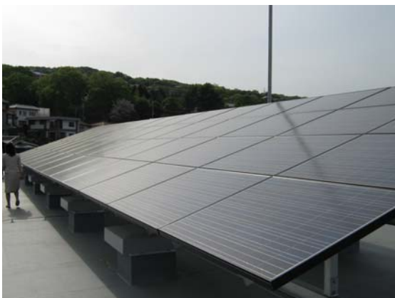
太陽光パネル（屋上設置 10kw）
