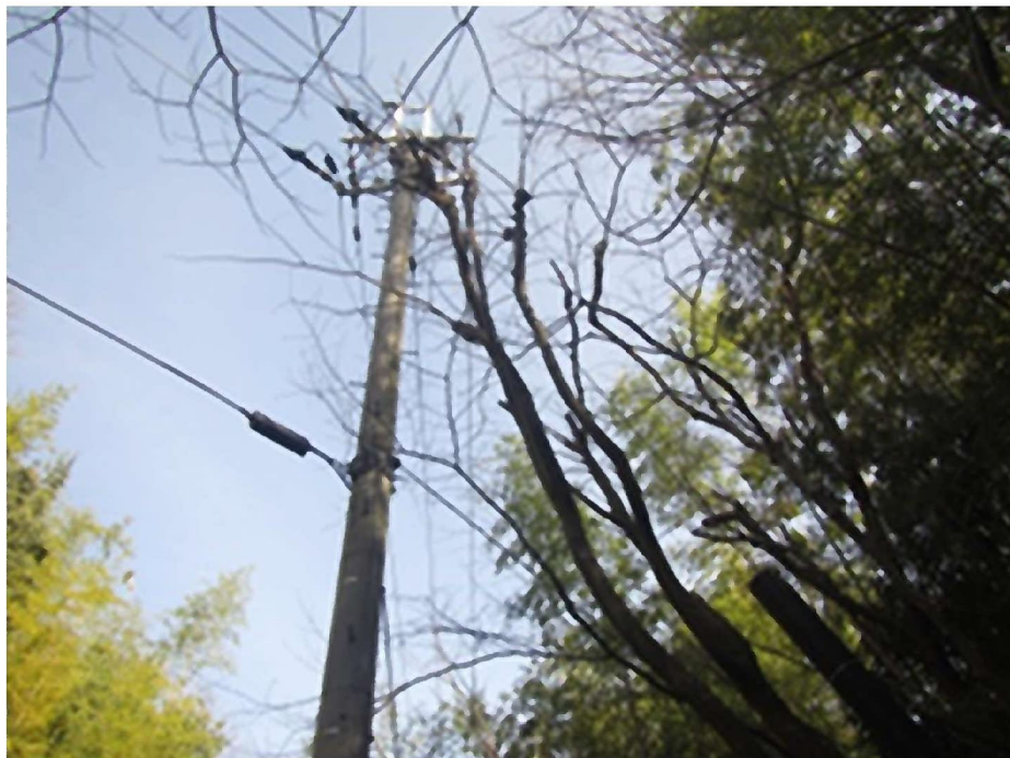
写真 5-1 荒廃状況の例（調査地 No. 4）
