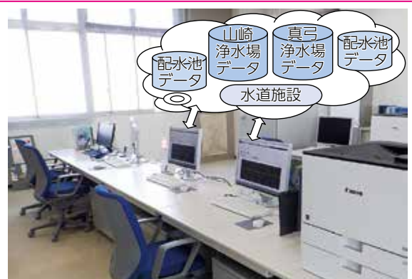
中央監視制御設備
