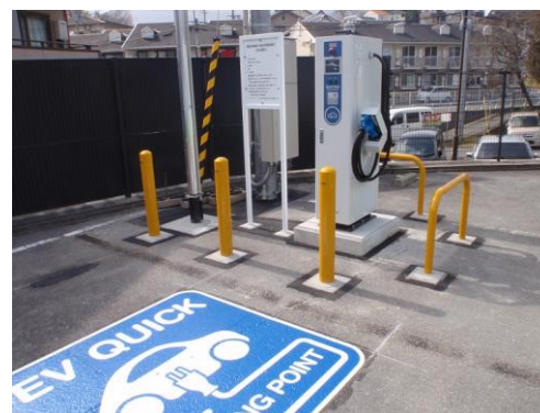
電気自動車用急速充電器
