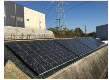
市民共同発電所4号機
