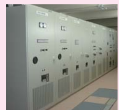
新しくなった電気設備
