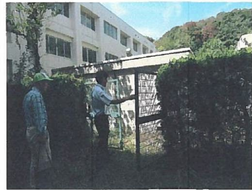
地上受水槽入口
