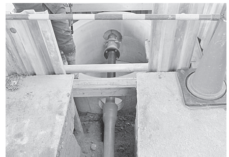
相互融通連絡管を通じて1日当たり一般家庭用槽約2,500基分の水道水を送ることができます
