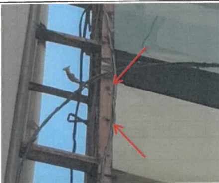
取付部(ボルトのゆるみや欠落)
