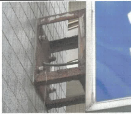
接合部(ブラケットの腐食劣化)
