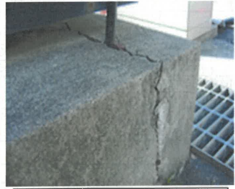
基礎部(基礎のクラック)
